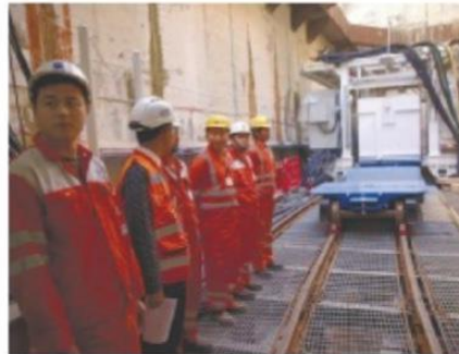
תחילת העבודות להקמת הרכבת הקלה בתל אביב, שבאחריות חברת נת"ע צילום: עופר וקנין
